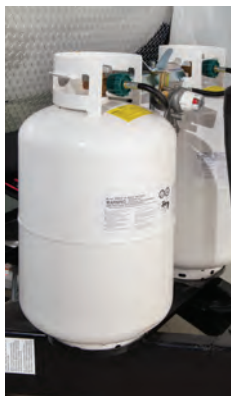
30# LP Tanks w/Cover
